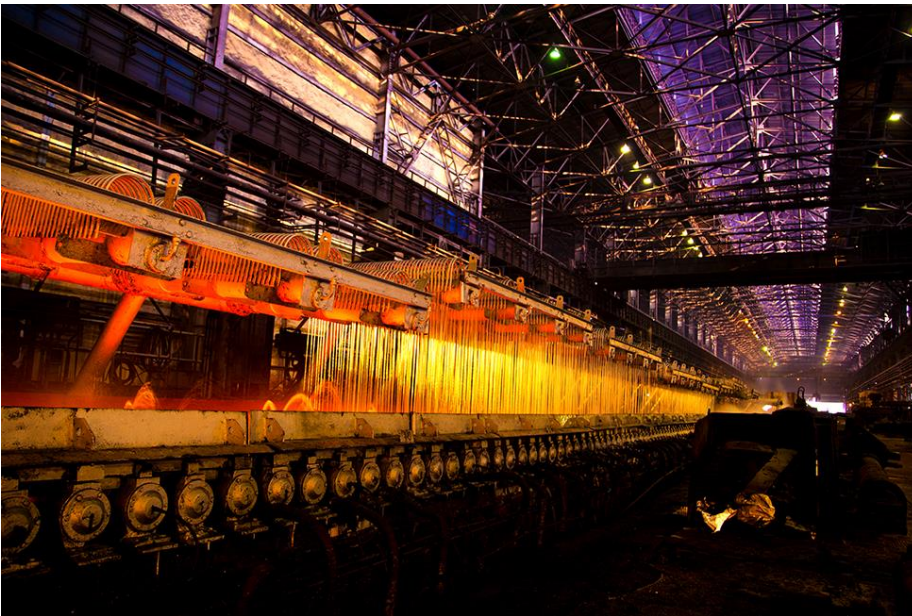
プライメタルズ テクノロジーズが自動化設備を更新した熱間圧延ラインの冷却セクション（更新対象: 仕上げ圧延機、冷却セクション、ダウンコイラー、コイルコンベヤ）
