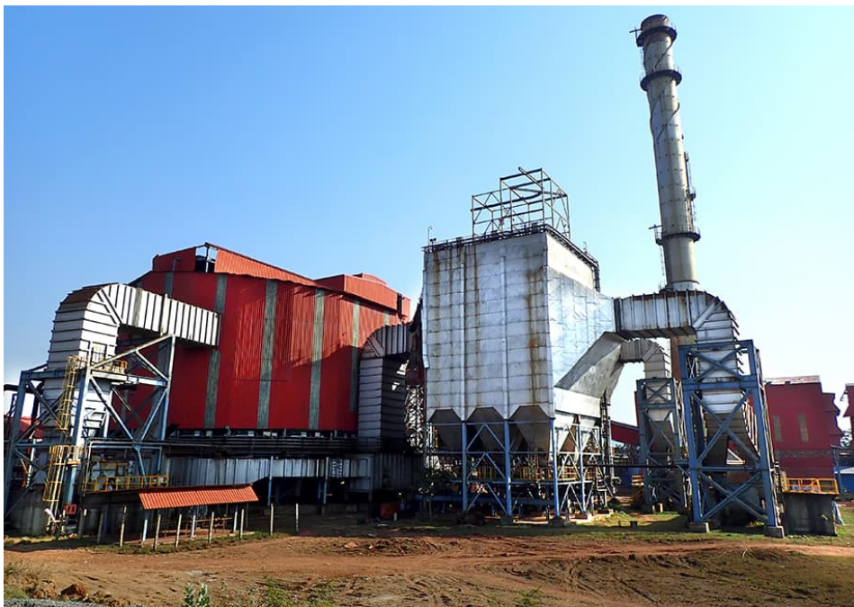
Фабрика на базе технологии CPT от Primetals Technologies на территории EMIL в Индии.
