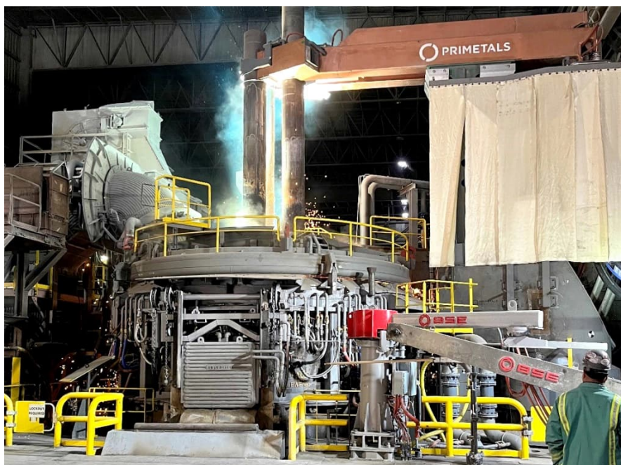
Forno elétrico a arco de 118 toneladas reformado pela Primetals Technologies, em sua primeira corrida.
