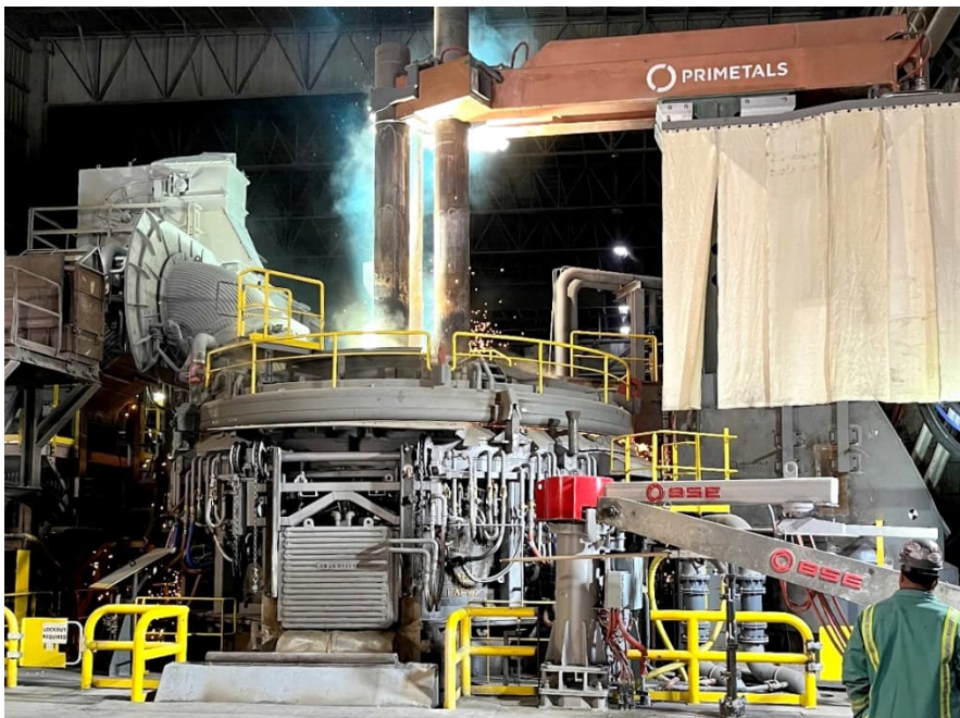
Der 118-Tonnen-EAF, der von Primetals Technologies überarbeitet wurde, bei der ersten Schmelze.
